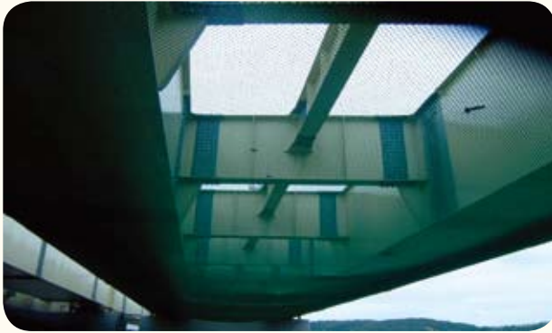
교량 상부공 하부 안전 방망
